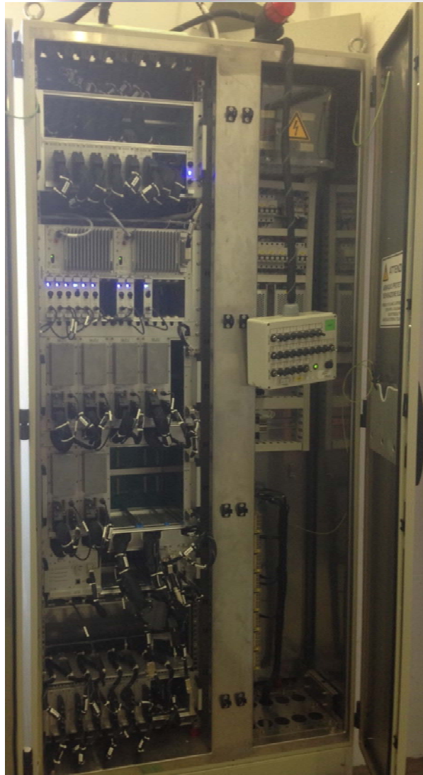
Armadio Encoder da Cabina (6 LEU) installato a Preglia
